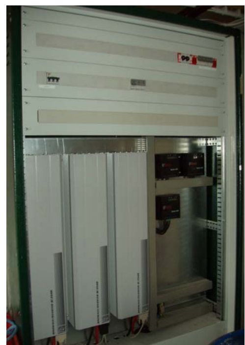
Schaltschrank mit Wechselrichtersatz und Stromverteilung
