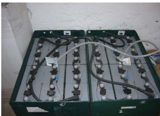
Batteriespeicher 48V/920 Ah
