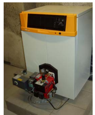
Pflanzenölbrenner mit Kessel
